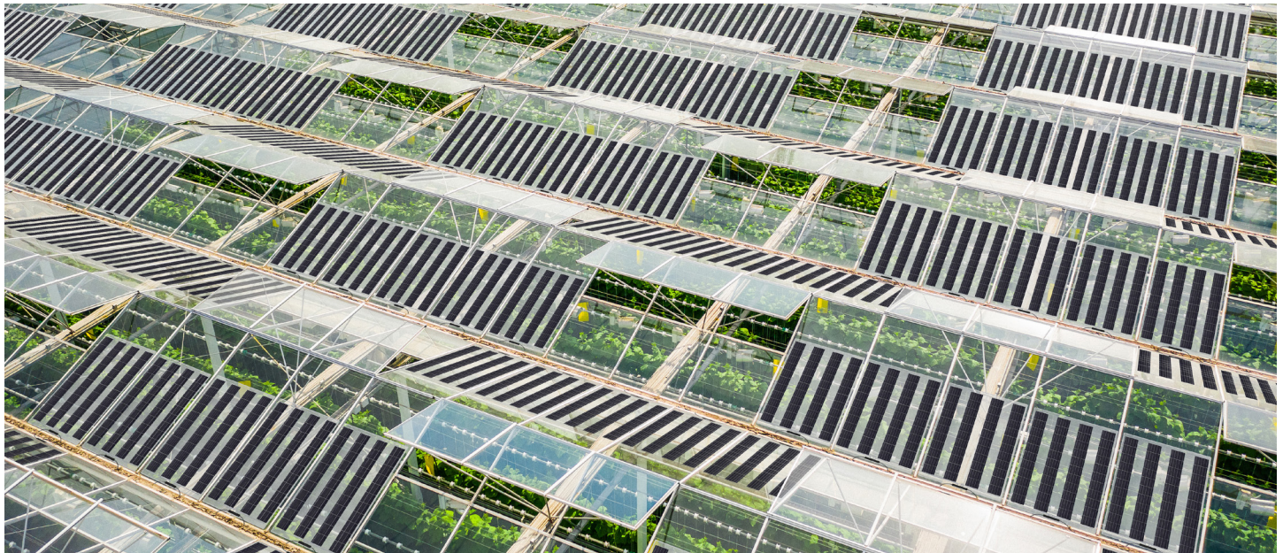
PV-Installation auf einem Gewächshaus
